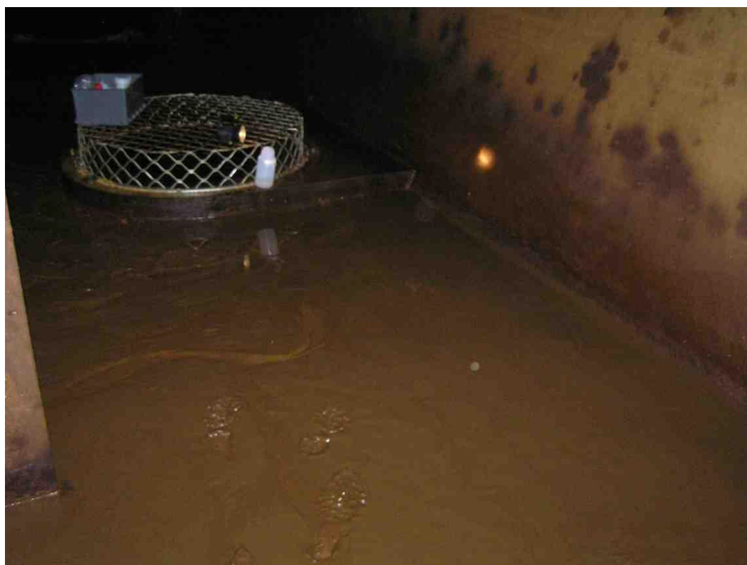
Figur 2. Rentvandstank (ca. 20.000 m 3 ) med aflejringer af sediment, pellets og partikler omkring tilløbene i tanken. Foto: sedimentet aflejret omkring et tilløb. Sedimenter er sammensat af jernoxider, kalkflager og pellets. Foto: W. Brüsich.
